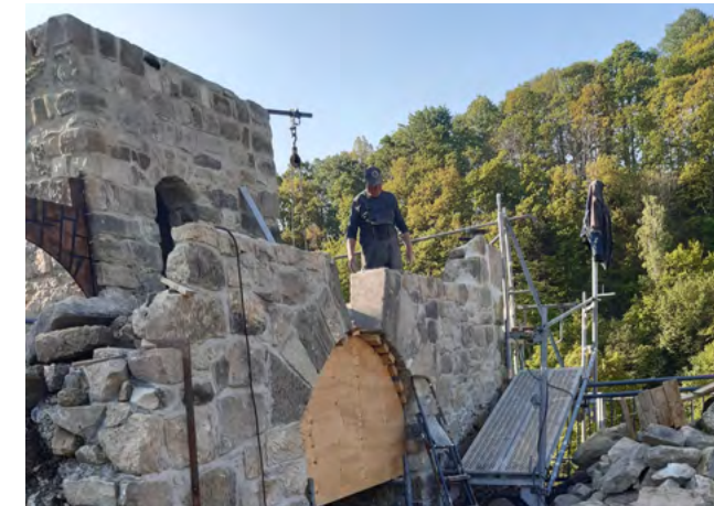
Schon sehr viele ehrenamtliche Stunden wurden bei der Sanierung der Burgranlage investiert. Danke den unermüdeten Helfern.
